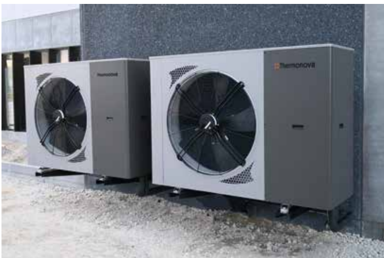
Udedel monteret på vægbeslag
